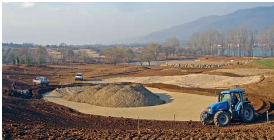
Baanconstructie en beregeningsinstallatie: de constructie en het maken van de 7e green wordt afgerond voor de installatie van de irrigatie.
